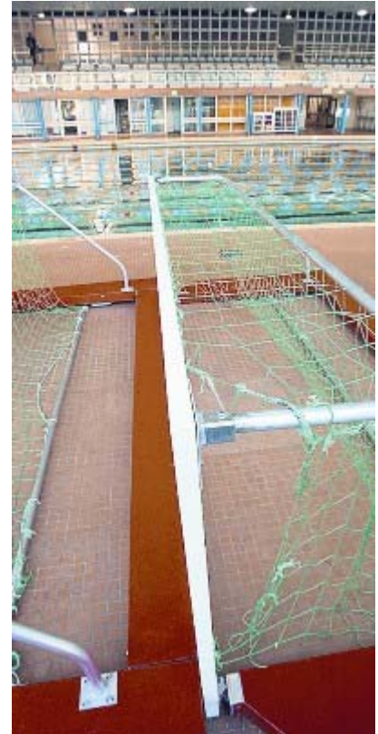
Die Wasserballtore setzen den Fliesen am Beckenrand stark zu.
